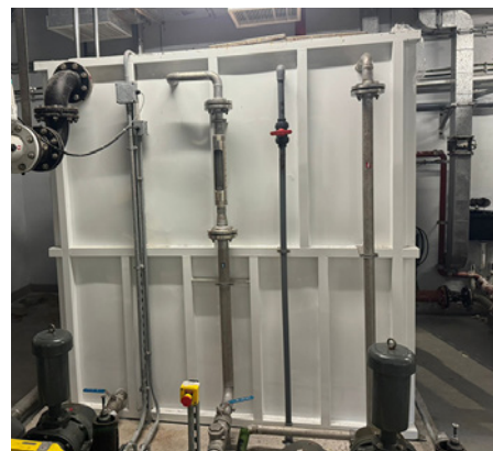
均衡池 Equalisation Tank
