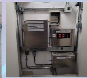
有線智能水錶需要較多空間和管道系統配合
